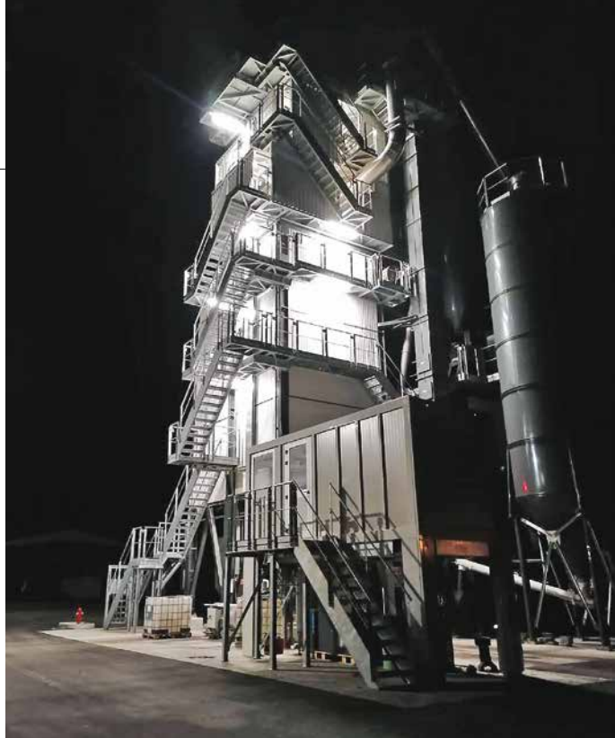
8. Vista notturna dell'impianto Top Tower 3000
