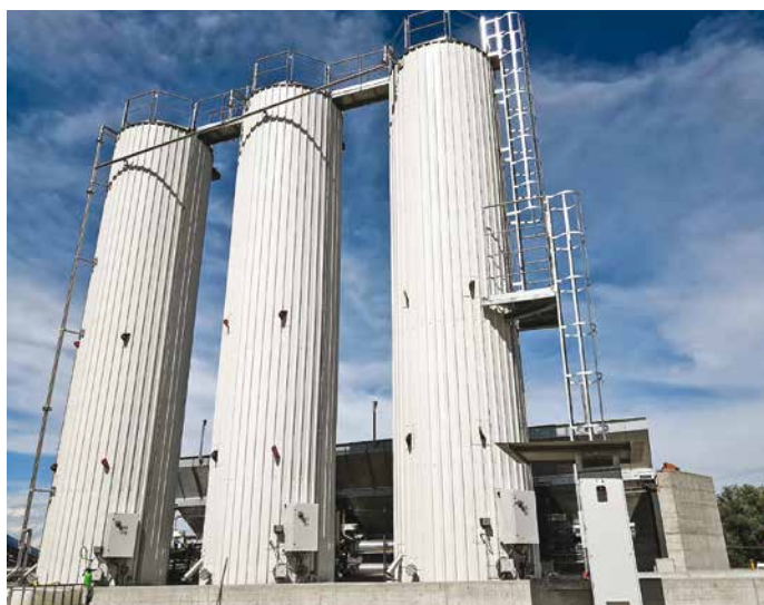
5. Le cisterne del bitume da 60.000 l ciascuna riscaldate elettricamente
